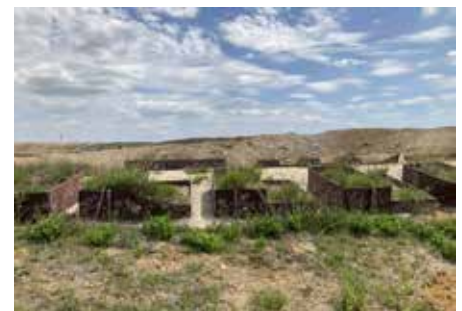
Essais sur site de traitement d'effluents par marais filtrant
