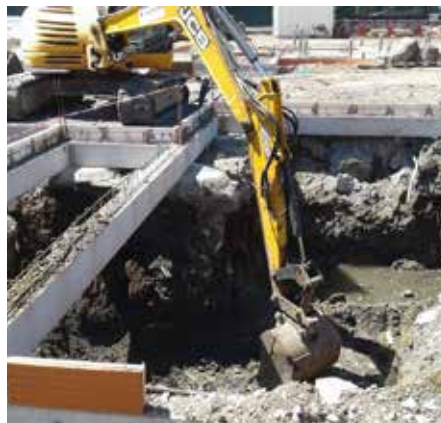
Exemple de travaux non anticipés
